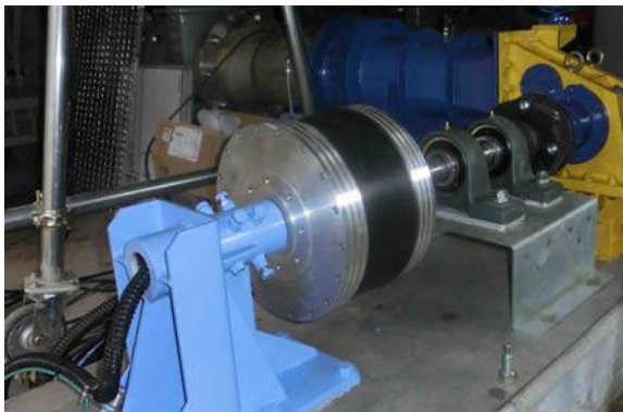
白系の滝小水力発電所(福岡県糸島市)
